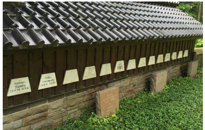
Die Grabplatten russischer Zwangsarbeiter finden jetzt in der Russischen Kriegsgräberstätte Simmerath-Rurberg eine würdige Unterkunft.
